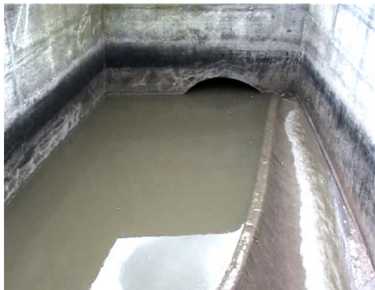
Figure 3-33 : Déversoir curviligne du réseau de Sélestat (DO 1)
