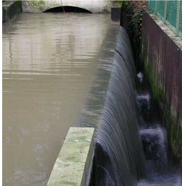
Figure 3-9 : Déversement au niveau du seuil du DO
