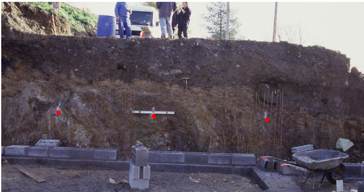
Figure 28 - Vue Est d'une tranchée lors d'une construction de la maison, au niveau de Bourréac, quelques kilomètres à l'est de la ville de Lourdes. Les points rouges indiquent le niveau horizontal.
