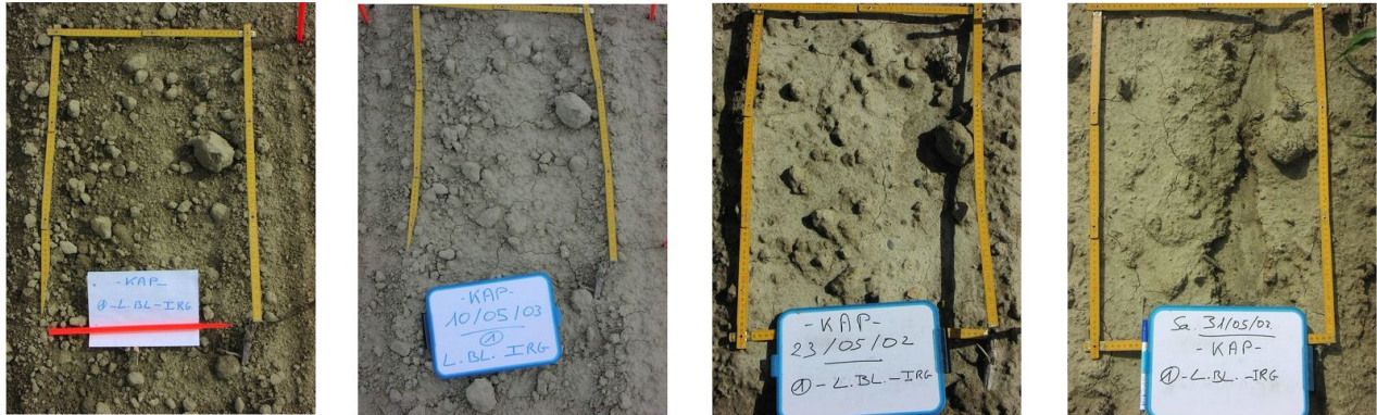
Figure 1.4 – Exemple de dégradation de la surface (Photos : R. Armand – 2003)
