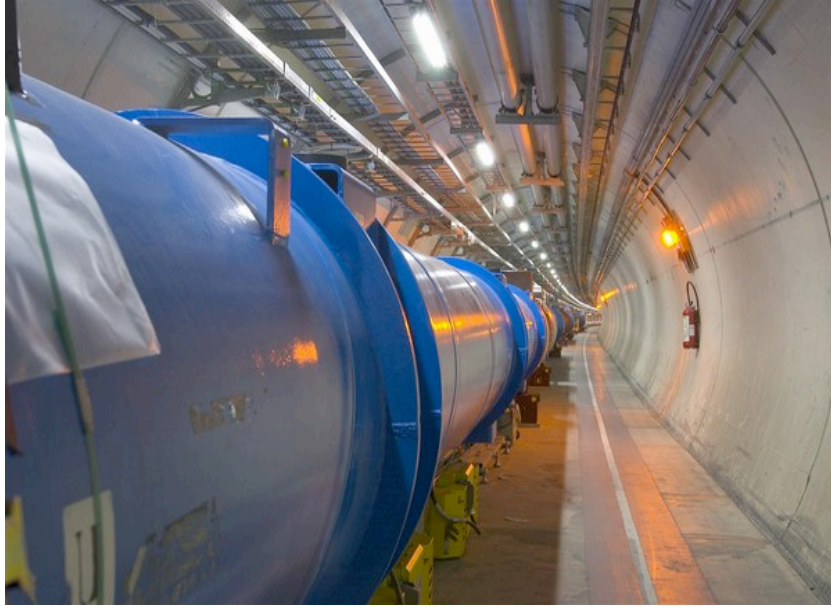
FIG. 2.6 – Vue du tunnel du LHC.
