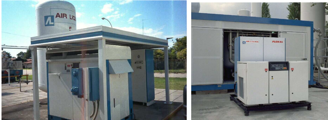
Bonbonne cryogénique couplée à un évaporateur Générateur couplé à un surpresseur Figure 8: Document Air Liquide
