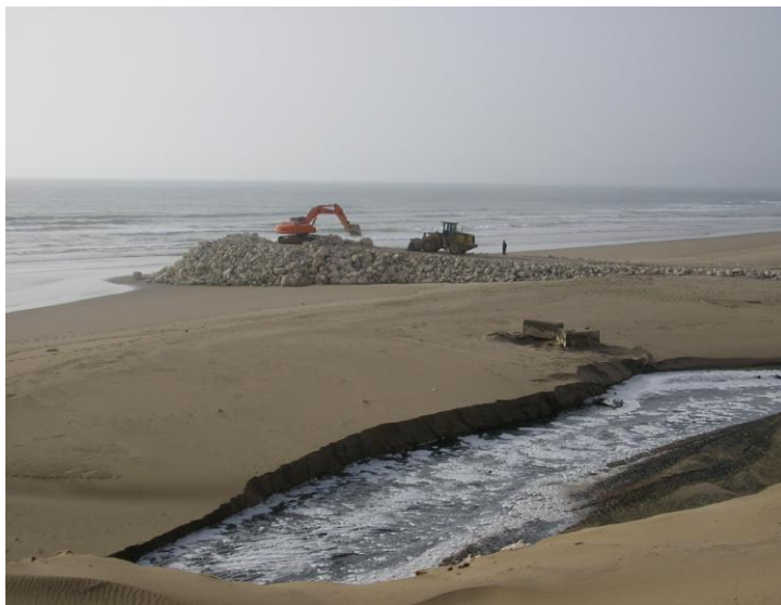
Annexe 14 : A et B : Rejet des eaux usées de la station L'Mzar au niveau de la plage Bouadisse (lors de la période de prélèvements de nos échantillons d'eaux usées et avant la construction de l'émissaire sous marin en 2007), C : Travaux de construction de l'émissaire sud
