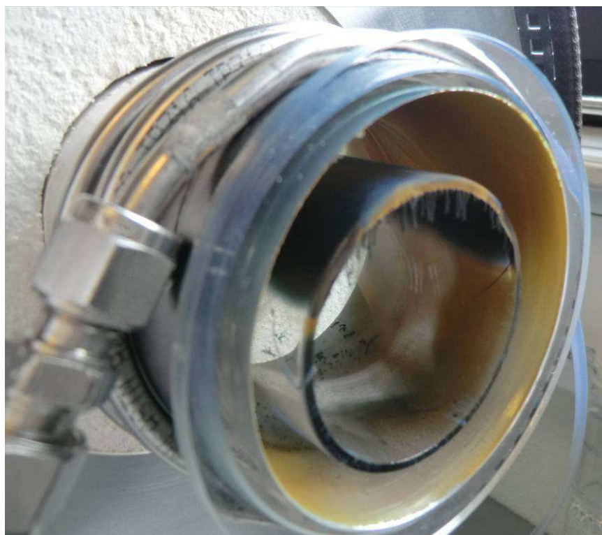
Figure 67 : tube bleui et dépôt de couleur rouille après la pyrolyse
