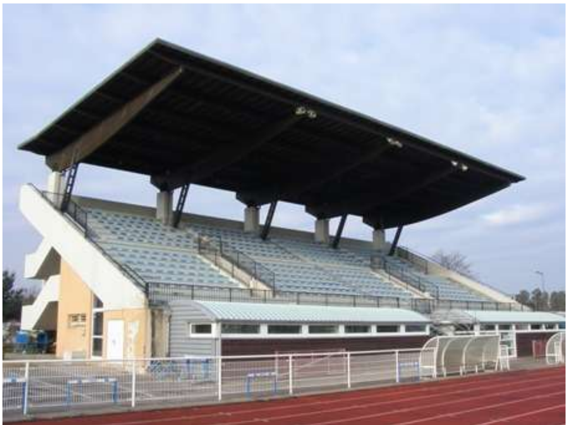
Photographie 32 : la grande tribune qui délimite le complexe sportif sur le devant (album personnel).
