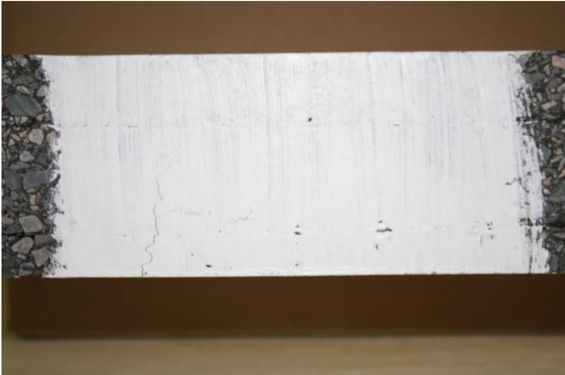
Figure i34. Etat de fissuration à 0h en flexion post-essai 4PB
