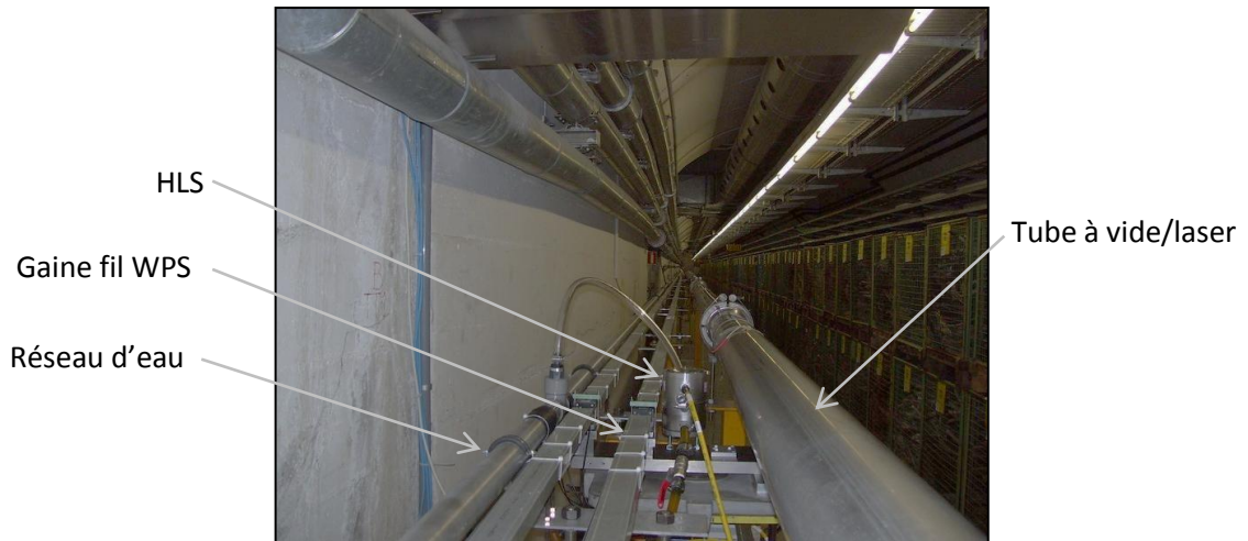
Figure 1-11 : Photo du centre de l'installation TT1
