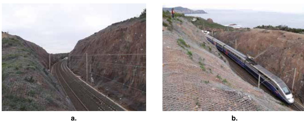
FIGURE I-3.5 – Exemple de tranchée rocheuse confortée par Grillage Plaqué Ancré - [Pollet, 2012]; (a.) Vue en bordure de la tranchée ; (b.) Vue depuis la crête
