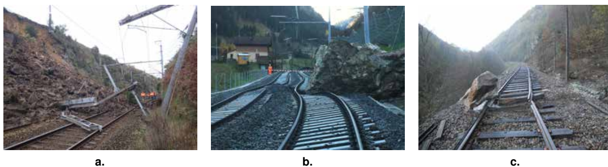
FIGURE 2 – Exemples d’incidents sur les voies ferrés - (a.) Éboulement d’un déblai rocheux à la sortie de la gare de Morlaix, dans le Finistère, le 25 janvier 2013 (1500 m 3 ) ; (b.) Un bloc de 80 m 3 termine sa chute sur les voies à Gurntellen, Suisse, en septembre 2012 ; (c.) Autre exemple de bloc en voie, incident du 11 août 2011, commune de Camps Saint Mathurin Léobazel (Corrèze).
