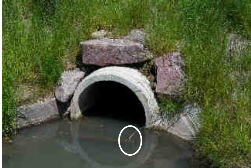
Figure 5-3. Mare de sédimentation n°3 - Sonde de pression à la sortie du réseau d'assainissement au niveau du répartiteur de débit (28/05/2013)
