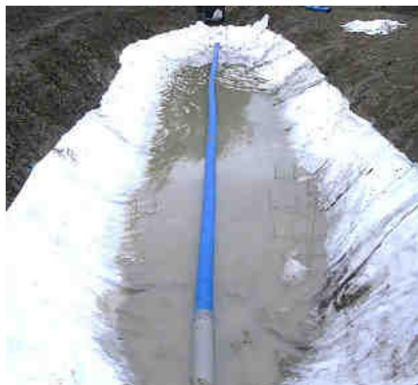
Figure 4-18. Filtre n°3 - Géotextile anti-poinçonnement et drain de collecte des eaux traitées (le 24/04/12)
