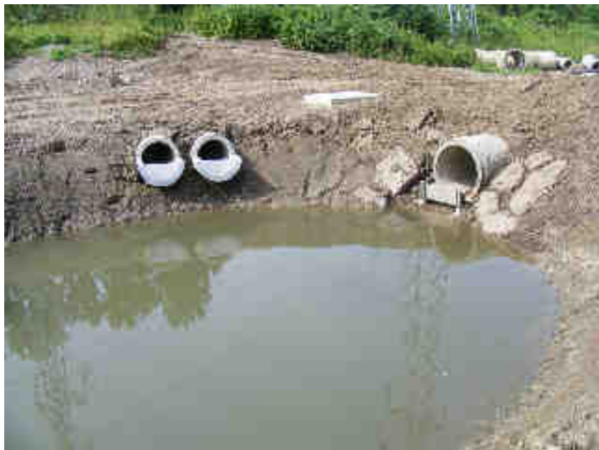
A gauche, canalisation de trop-plein vers le milieu naturel, à droite, dispositif de répartition du débit et enrochements à la sortie du réseau d'assainissement
