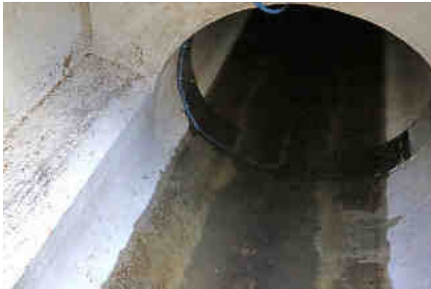
Figure B-1. Vélocimètre à effet Doppler dans le réseau d'assainissement du bassin versant n°3
