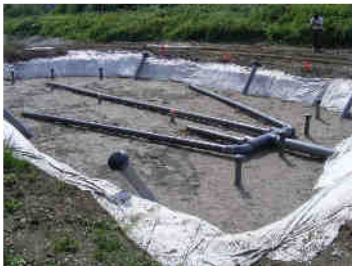
Figure 4-26. Filtre n°1 - Vue des cheminées d'aération de fond et intermédiaire et du dispositif d'alimentation (le 04/07/2012)
