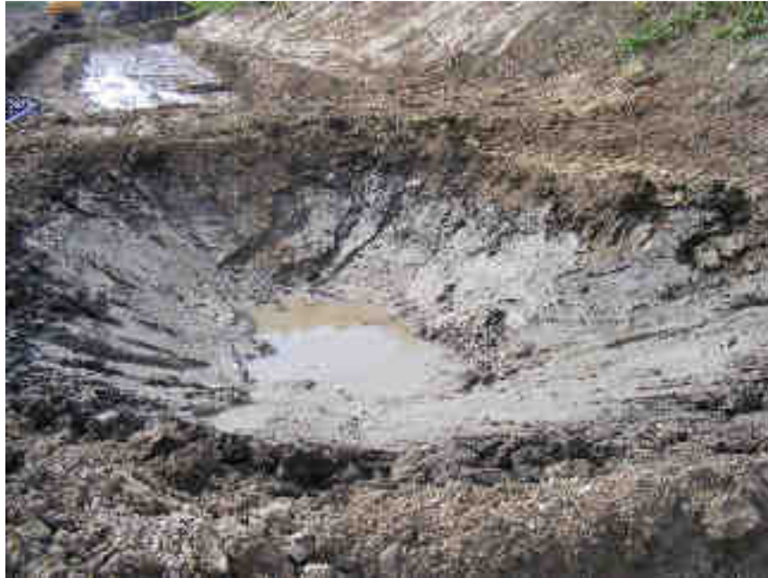
Figure 4-10. Mare de sédimentation n°3 - Mise en place de la couche d'étanchéité en argile (le 17/04/12)
