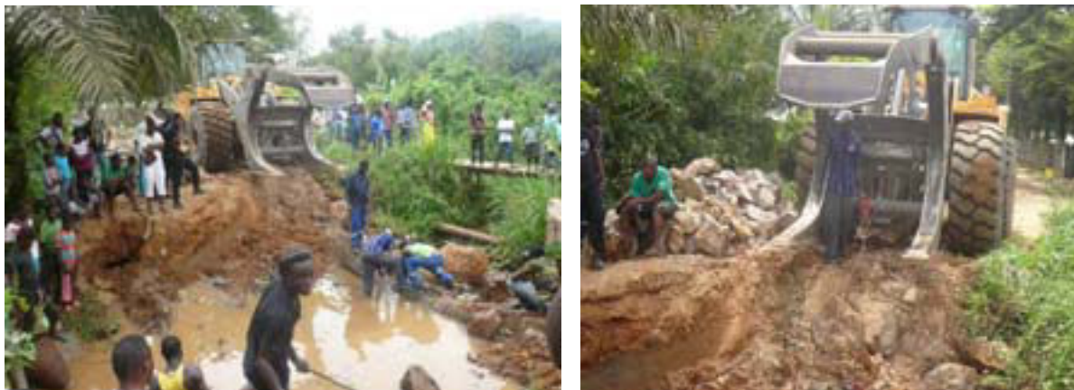
Photos 63 et 64: Réfection d'un pont reliant deux quartiers par les employés l'entreprise un jour férié
