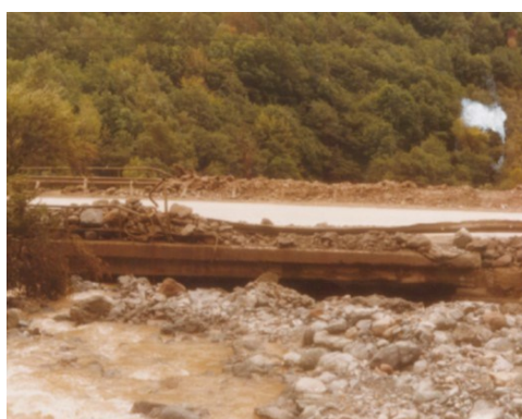
Figure 104 : Pont de la RN91 à l'issue de la lave torrentielle du torrent de la Vaudaine du 10 août 1983 (RTM 38, ONF).
