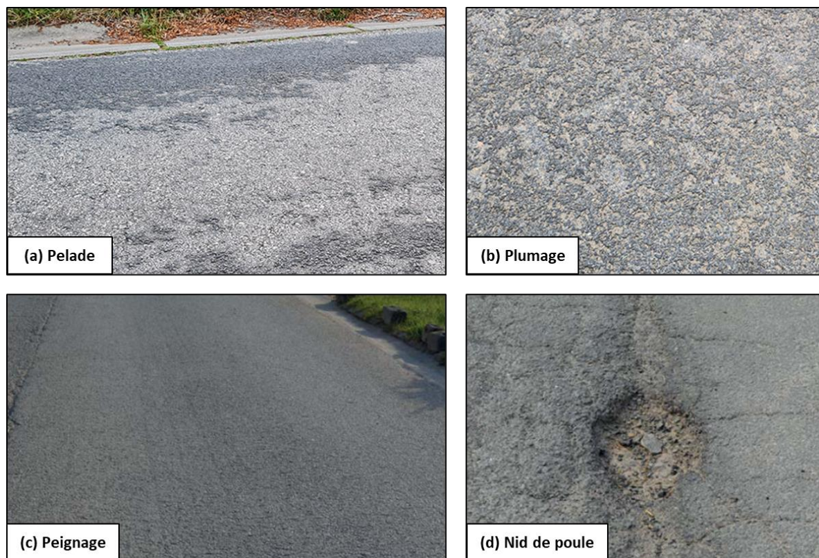
Figure 1.4 Désordres par arrachement (photos (a) et (b), site internet TP Demain, 2020 ; photos (c) et (d), CRR MF 89-rév1, Annexe, 2020, respectivement p. 19 et p. 16).
