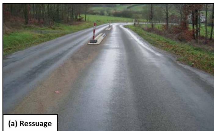
Figure 1.7 Désordres par mouvement de matériaux (photo CRR MF 89-rév1, Annexe, 2020, p. 21).
