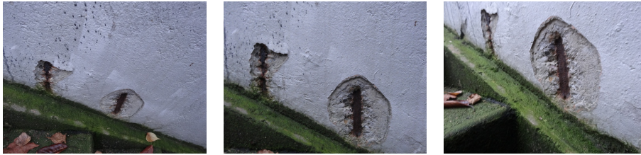
FIGURE 2.6 – Exemples d’images du tunnel piéton représentant la même zone avec différents points de vue. Sur chaque image, les deux mêmes fers apparents sont présents.
