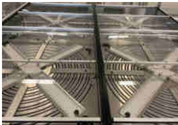
Figure 10 : Frigos de la ligne de remplissage S2 de la ligne de remplissage S2 de l'unité de production 2 à Delpharm Huningue
