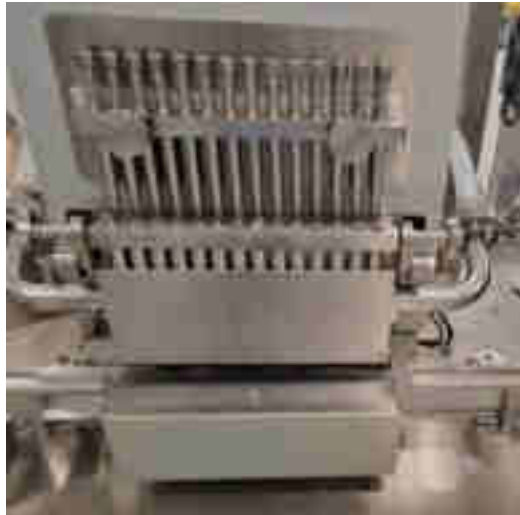
Figure 8: Aiguilles de remplissage de la ligne de remplissage S2 de l'unité de production 2 à Delpharm Huningue
